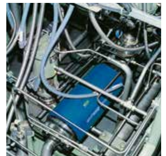
Caudalímetro KRAL instalado en el compartimento del motor de un yate.
