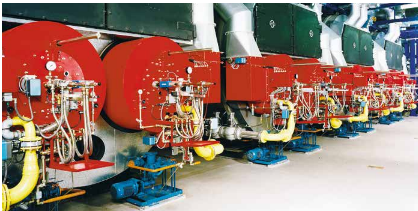
Районная тепловая электростанция с горелками, работающими на промышленном масле/газе с одиночными станциями KRAL.
