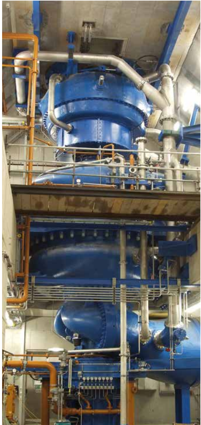
Насос и преобразователь в подземной электростанции.
