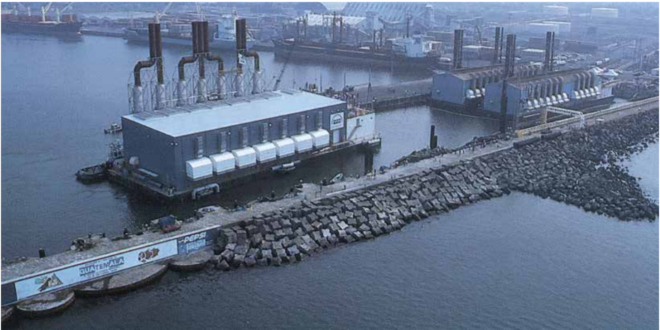
Плавучая электростанция для децентрализованных генерирующих станций.
